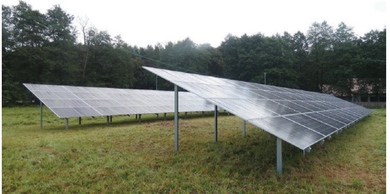
Przy Ośrodku Wypoczynkowym „Sobótka” już zainstalowano panele fotowoltaiczne.
