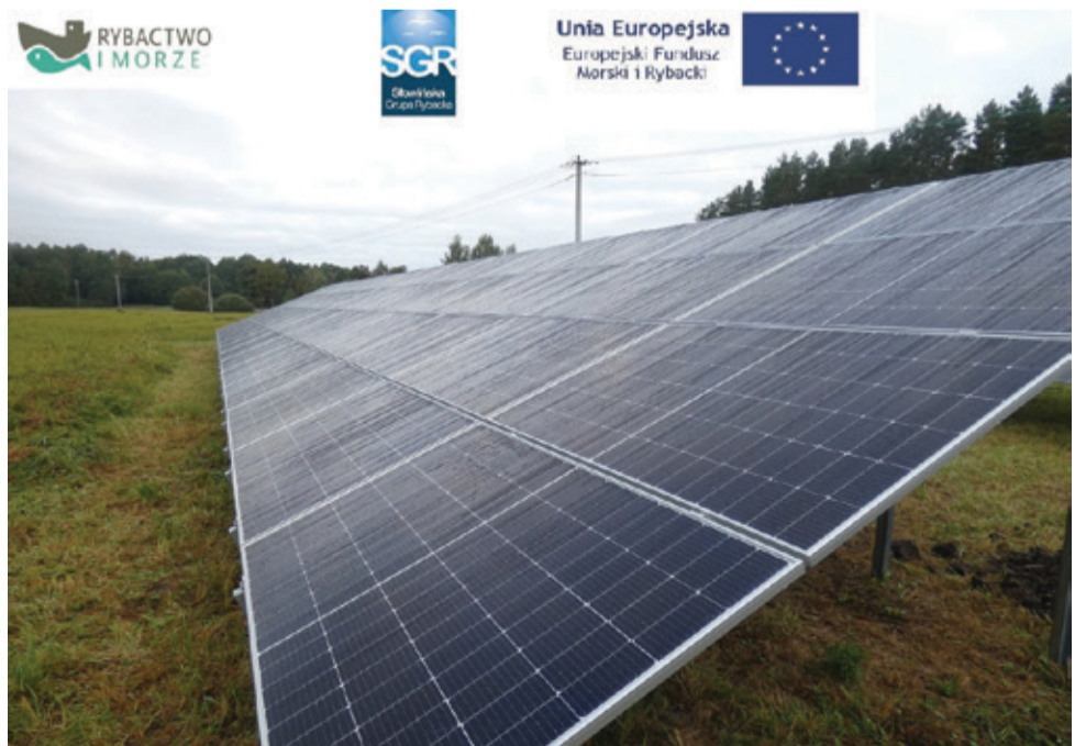
Instalacja przyczyni się do obniżenia kosztów eksploatacyjnych ośrodka.
